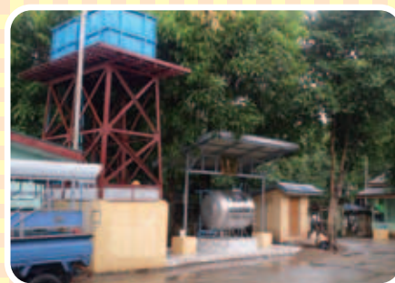
水供給施設(井戸、貯水タンク、ポンプ)
